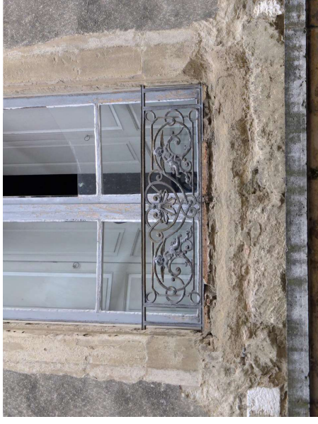
Menuiseries anciennes homogènes à petits bois et volets intérieurs, Garde-corps fonte à angelots tous niveaux
