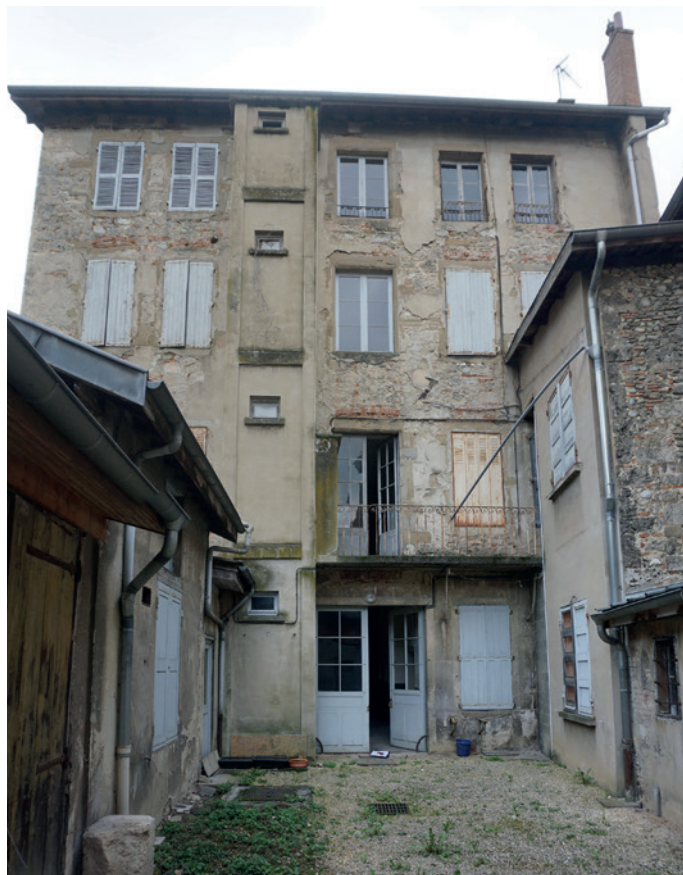
42 Grande Rue - Elévation arrière Tour de sanitaires postérieure et chutes d'enduit
