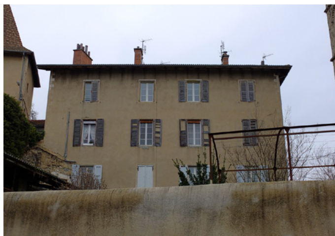
1 passage du Bon Secours - Façade sur jardin en cours de dégradation : perte des décors, des volets, des menuiseries...
