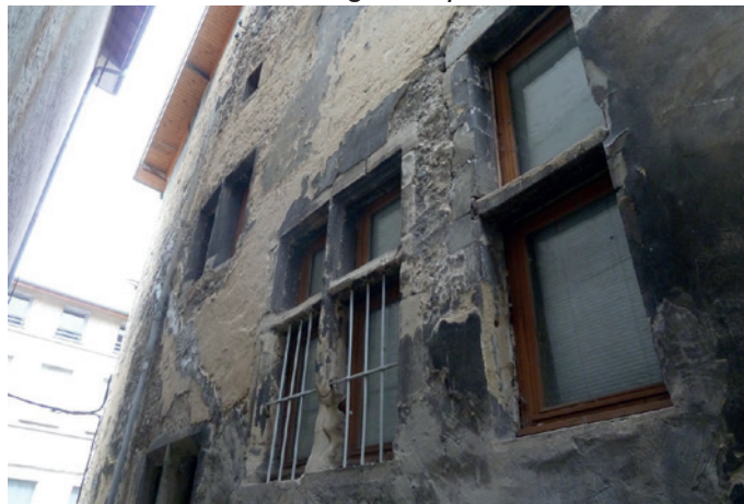
4 Grande Rue - Baies à meneaux et traverses du XV e siècle sur rue arrière
