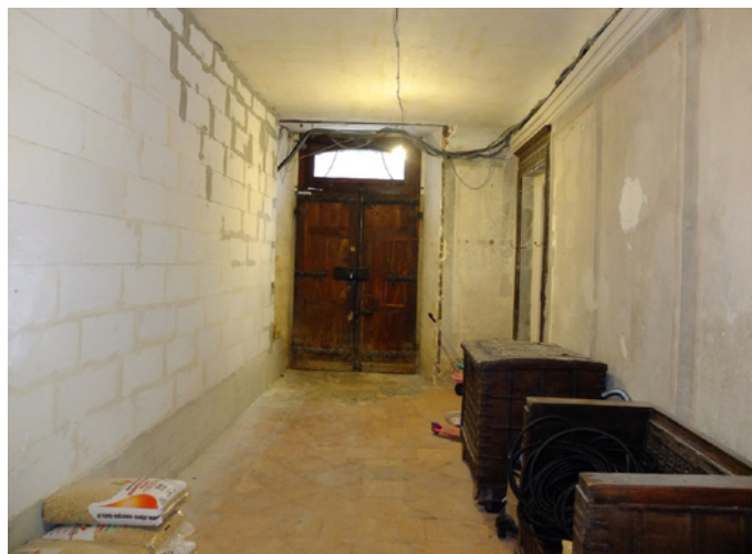
40 Grande Rue - Altération par extension du commerce dans le vestibule
