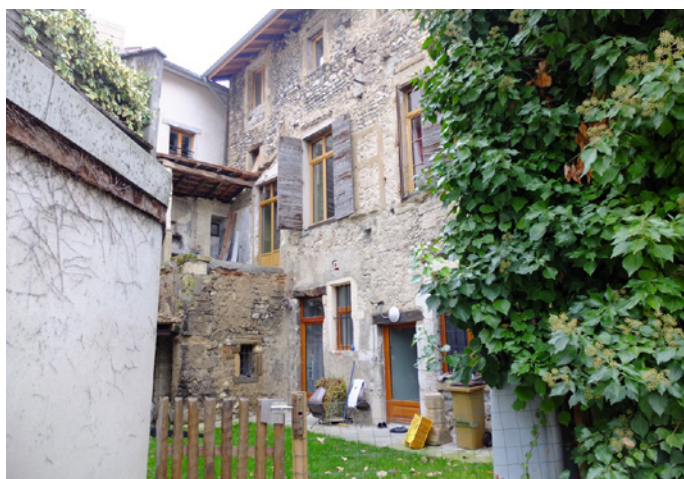
40 Grande Rue - Façade sur cour de service : dégradation des structures, changement des menuiseries
