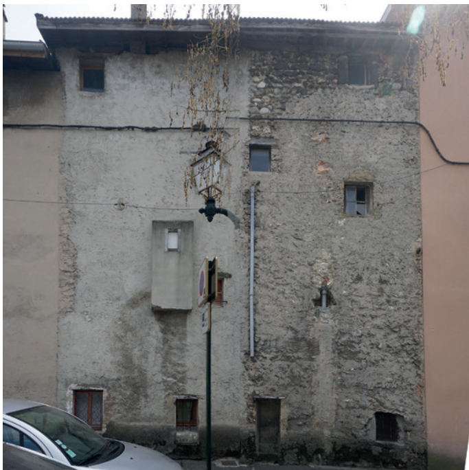
Façade arrière du 30 boulevard Gambetta. Le rez-de-chaussée a été percé de cuisines dotées de petites baies. Un WC a été ajouté en hors œuvre au premier niveau. L'ensemble demeure peu percé.
