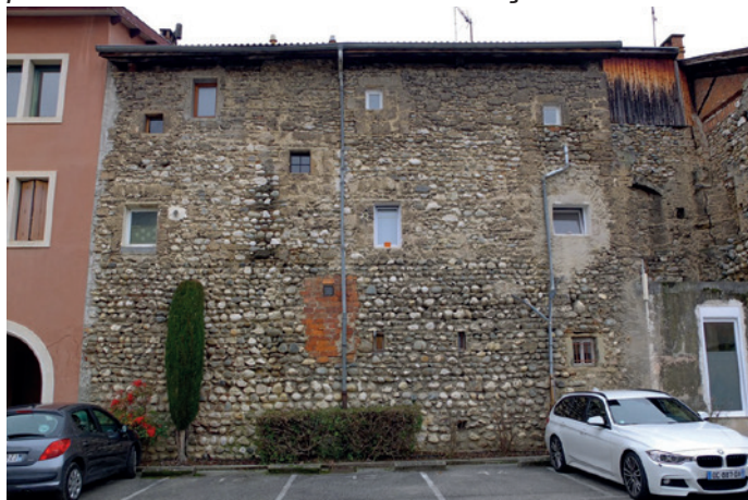
Façade arrière d'un immeuble de rempart, boulevard du Champ-de-Mars, surélévation du rempart
