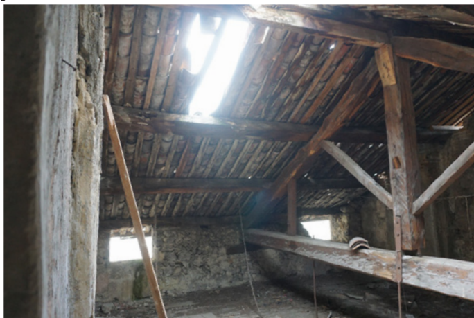
44 Grande Rue - Charpente et comble Trous en toiture, infiltrations massives, péril imminent 32
