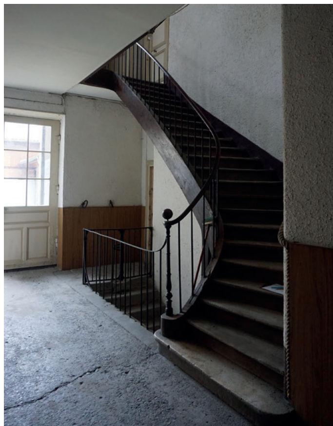
42 Grande Rue - Palier du R+1 Escalier suspendu et accès balcon sur cour
