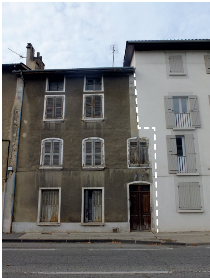
Façade principale sur cours Gambetta Lisibilité de la surélévation par différenciation des linteaux, vestiges de décors peints Déport du mur mitoyen
