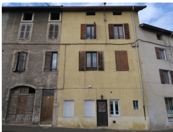
12 rue du Faubourg Vinay - Façade avec enduit non qualitatif, volets non persiennés, fenêtres sans partition, rez-de-chaussée sans composition
