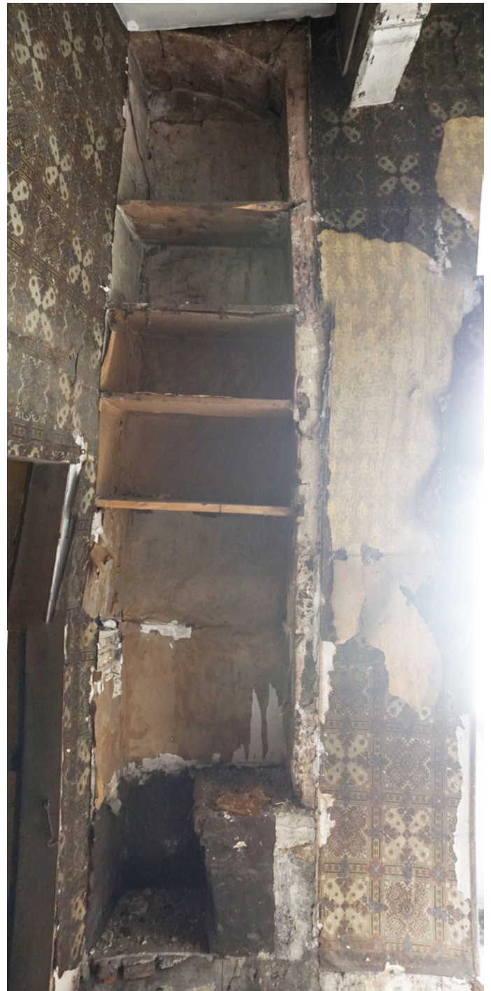
44 Grande Rue - Intérieur du premier niveau - Embrasure d'ancienne baie à coussiège et décors peints
