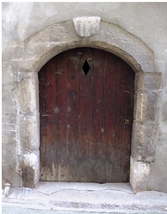
44 Grande Rue - Porte sur rue de Garagnol Encadrement du XVI e siècle avec blason sculpté
