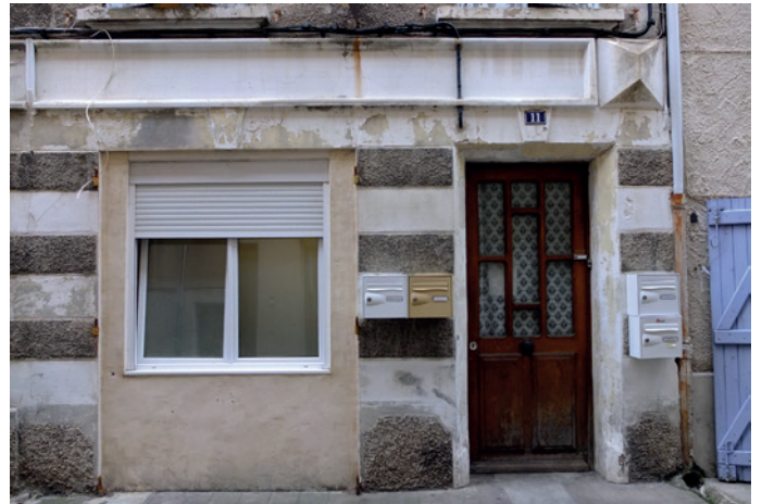
11 rue de France - Rez-de-chaussée remanié XX e s. Réseaux électriques et eaux usées apparents.
