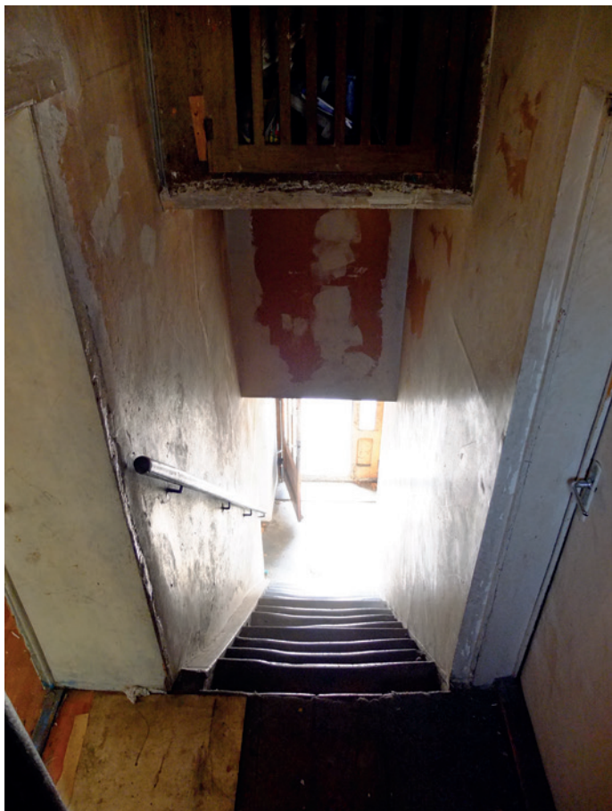
Escalier droit en bois, mauvais état général
