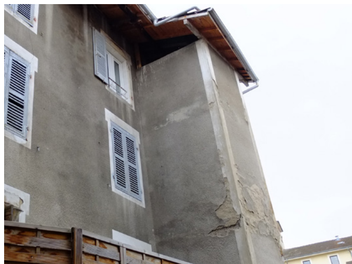
11 rue de France - Façade arrière altérée : enduit dégradé, manque un volet, fenêtre PVC avec des montants larges
