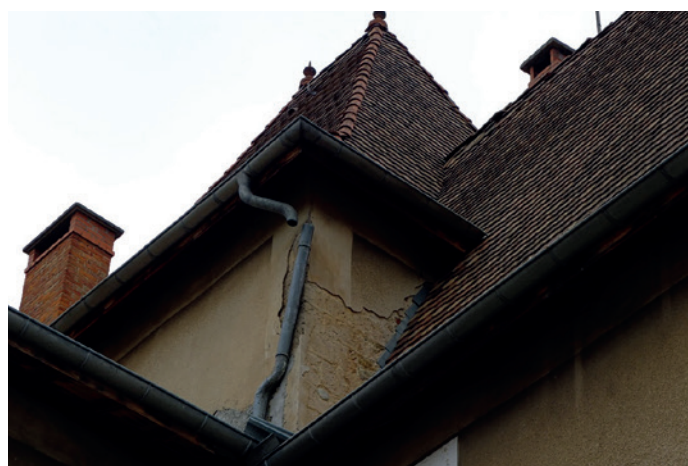
Château - Élévation sur cour - Enduits et décors anciens, dégradations en raison de mauvais raccordements
