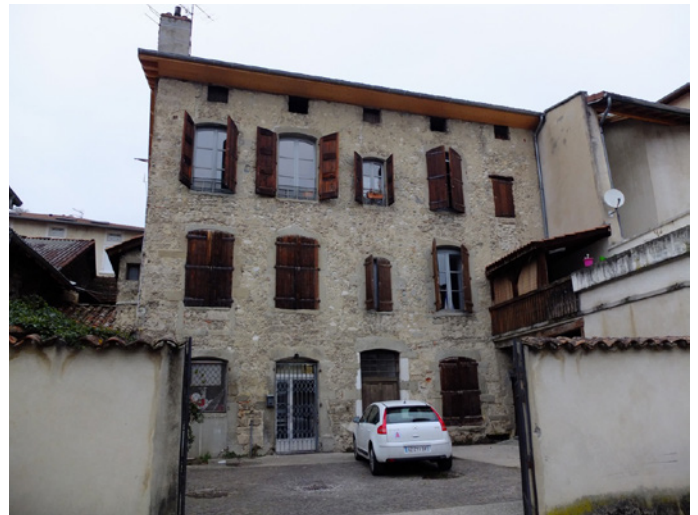
57 Grande Rue - Façade arrière largement altérée : disparition des décors enduits et peints, disparition des menuiseries anciennes, volets non entretenus, ajout d'éléments de serrurerie, adossement d'édicules, modification des percements, disparition des garde-corps en fer forgé...
