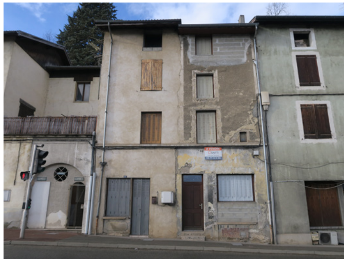
16-16b rue du Faubourg Vinay - Façade avec enduit altéré, volets pliants métalliques, devanture disparue
