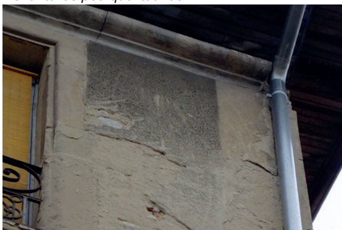
42 Grande Rue - Elévation sur rue Tracées d'enduits et décors peints anciens
