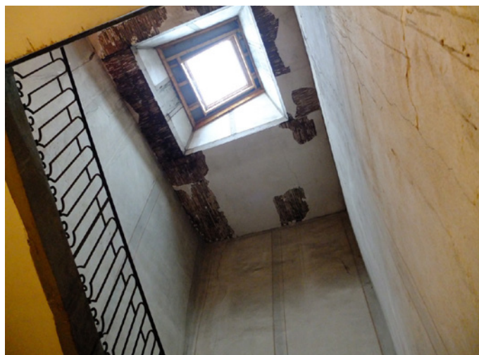
40 Grande Rue - Altération par défaut d'entretien des toitures, disparition des décors peints, péril des structures
