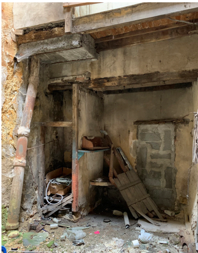
44 Grande Rue - Cour intérieure Délabrement de l'extension côté nord
