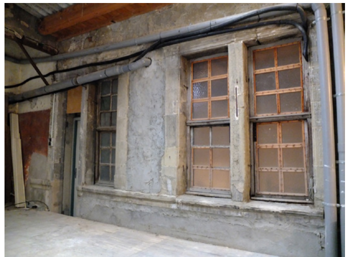
53 Grande Rue - Ancienne façade sur cour après fermeture, passage sauvage d'éléments techniques
