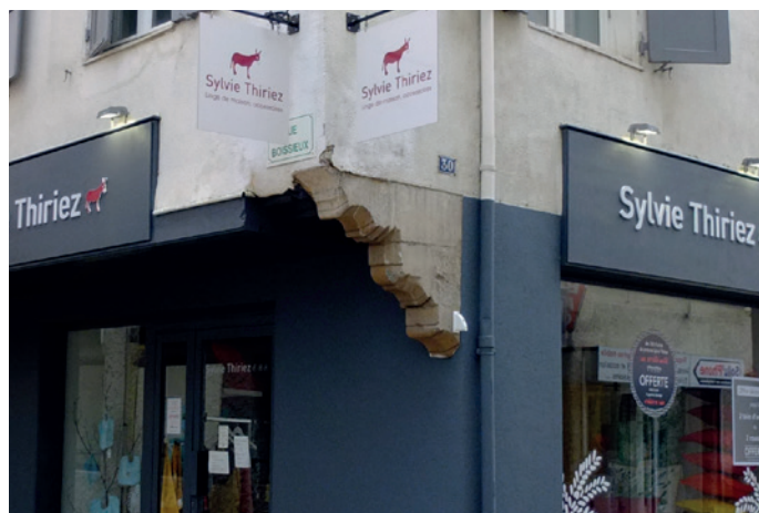
30 Grande Rue - Façade portée sur une poutre bois reposant sur deux consoles de molasse sculptées
