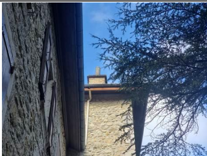
Photo n° PhA007 Localisation : Rez de chaussée - Salle d'eau/WC; Rez de chaussée - Atelier; Rez de chaussée - Local Cuve; 1er étage - Atelier; Batiment OUEST / 1er étage - Plateau; Parties extérieures Ouvrage : 6 - Conduits et accessoires intérieurs - Conduits de fluides (air, eau, vapeur, fumée, échappement, autres fluides) Partie d'ouvrage : Conduit en fibres-ciment Description : Conduit en fibres-ciment
