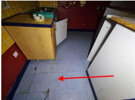
Photo n° PhA004 Localisation : 3ème étage - Bar Ouvrage : 5 - Planchers et planchers techniques - Revêtements de sols Partie d'ouvrage : Dalle de sol Description : Matériau de type colle (collant) (transparent)
