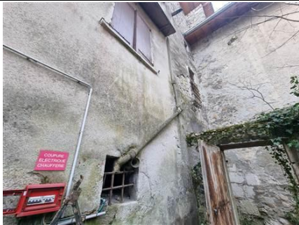
Photo n° PhA007 Localisation : Rez de chaussée - Salle d'eau/WC; Rez de chaussée - Atelier; Rez de chaussée - Local Cuve; 1er étage - Atelier; Batiment OUEST / 1er étage - Plateau; Parties extérieures Ouvrage : 6 - Conduits et accessoires intérieurs - Conduits de fluides (air, eau, vapeur, fumée, échappement, autres fluides) Partie d'ouvrage : Conduit en fibres-ciment Description : Conduit en fibres-ciment
