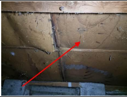
Photo n° PhA006 Localisation : 1er étage - Atelier Ouvrage : 4 - Plafonds et faux plafonds - Faux plafonds Partie d'ouvrage : Panneaux et plaques Description : Panneaux et plaques
