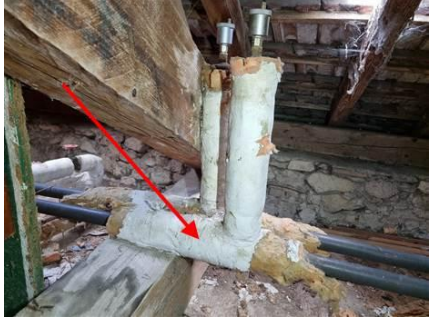
Photo n° PhA002 Localisation : 3ème étage - Combles Ouvrage : 6 - Conduits et accessoires intérieurs - Conduits de fluides (air, eau, vapeur, fumée, échappement, autres fluides) Partie d'ouvrage : Calorifuge (tresses, coquilles, matelas...) Description : Matériau de type peinture (blanc) ; matériau de type maillage de fibres (blanc)
